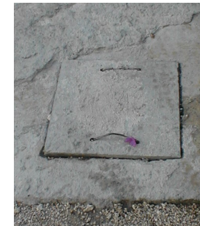
Fosa séptica: no hay tratamiento, vierte directamente al manto freático
